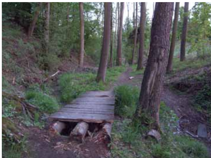
Poškozená návštěvnická infrastruktura v údolí Cholupického potoka
