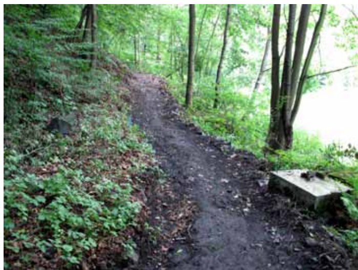
Přibližně stejné místo na stezce jako na předchozím obrázku po "neautorizované" opravě. Jak je patrné z fotky, v pláni stezky je rozhrnutý humus, který bude působit problémy s rozmáčením, a není vymodelovaný příčný odklon pláň pro dobré odvodnění
