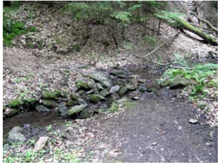
Neudržovaný, rozvalený brod na staré stezce (Plzeň, Zábělá)
