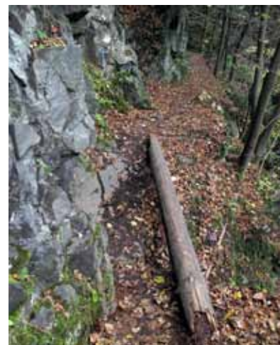
Utržená vnější hrana stezky je častým případem poškození stezky (Štěchovice)
